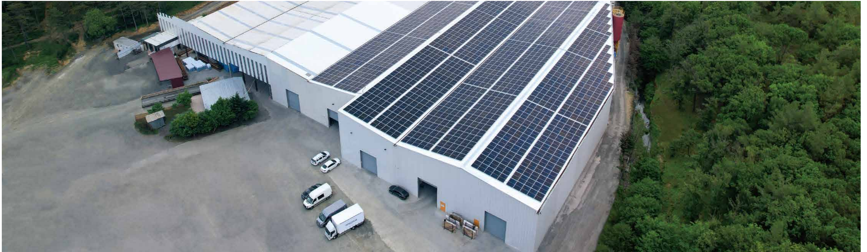
04 Snížení Nákladů na Energii pro Továrnu na Minerální Vodu Turecko, 900kW KSG-120CL-M0
